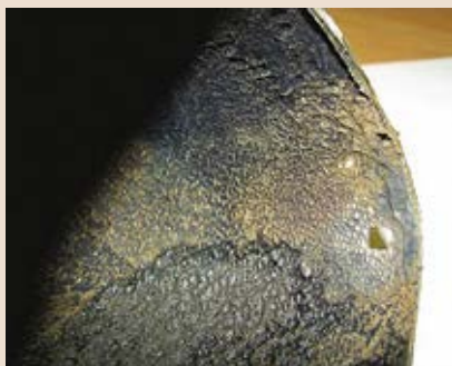
Рис. 2. Коррозионно-эрозионное повреждение внутренней поверхности трубы. Осмотр магистральной трубы показал коррозионно-эрозионное повреждение в области сгиба
