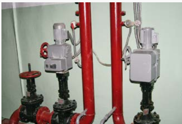
Система пожаротушения ГЭС
