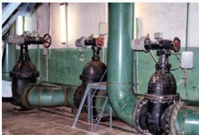
Насосная ТВС (Техническое водоснабжение для охлаждения гидроагрегатов)
