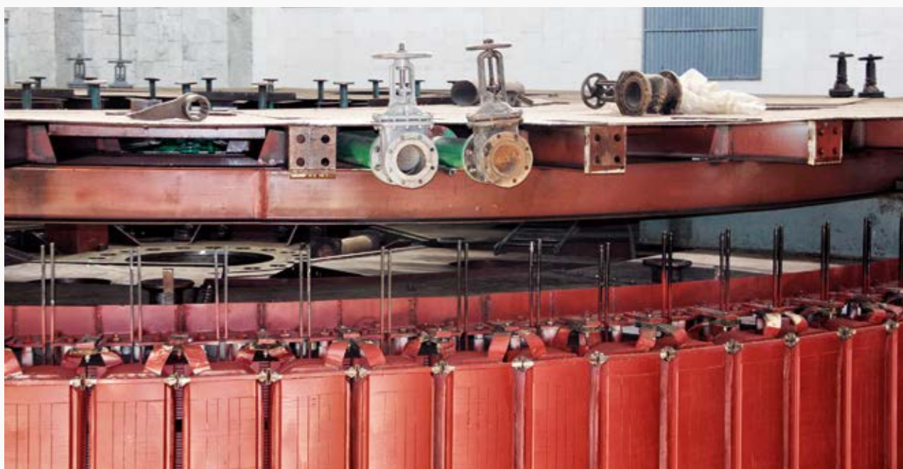
Задвижки на системах охлаждения гидроагрегата
