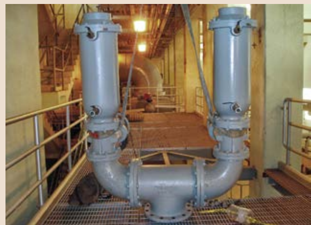
Воздухоотводчики с установленными под ними задвижками на станции очистки сточных вод
