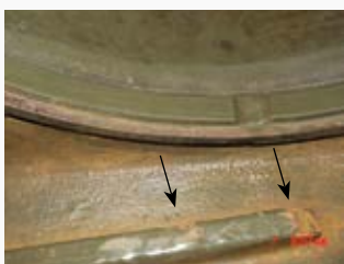
Коррозия направляющей первого диска
